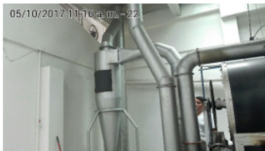
FOTO 5. Sistema de control tostadora
