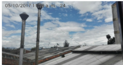
FOTO 4. Ductos de desfogue de la tostadora
